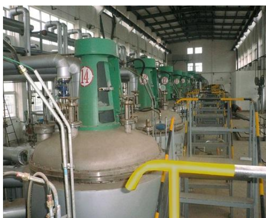
图十四 某公司5万吨苯连续硝化生产装置
