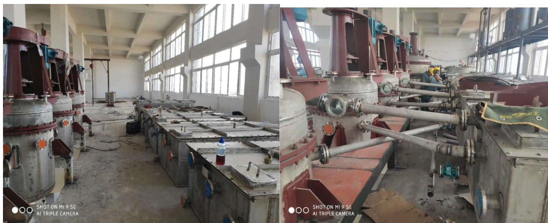
图十六：宁夏某公司三氟甲苯连续硝化装置现场图
