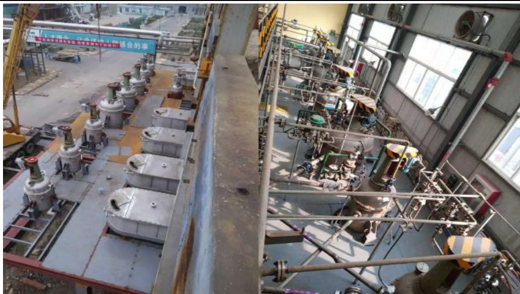
图十五：山东某公司二甲戊胺连续硝化装置现场图
